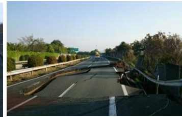
②九州自動車道 （益城熊本空港IC～嘉島JCT） 盛土法面が崩落し、路面が陥没
