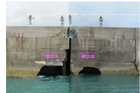
H26.8台風で被災したケーソン (漁港漁場課提供)
