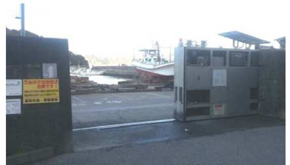
〔陸閘機械化 事例〕
