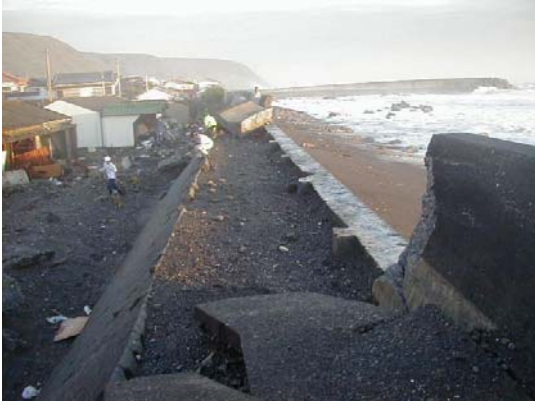
〔菜生海岸被災状況（室戸市）〕
