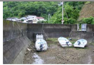
③水門状況
