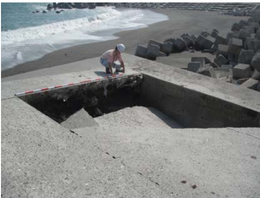
〔戸原海岸被災状況（高知市）〕
