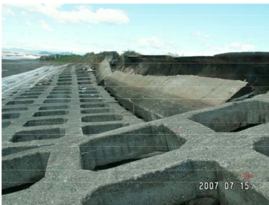
〔吉川海岸被災状況（香南市）〕
