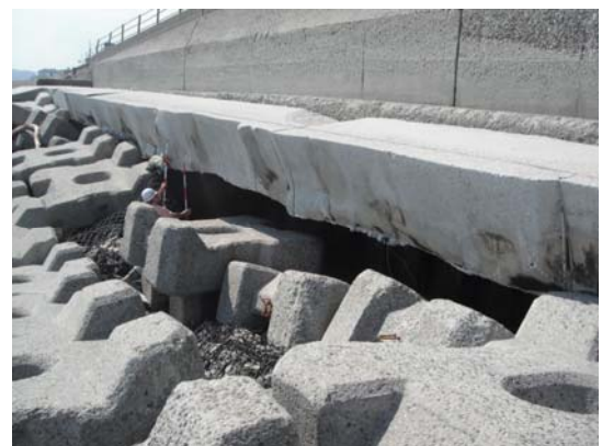
〔長浜海岸被災状況（高知市）〕
