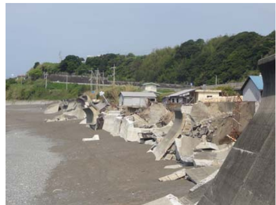
〔穴内海岸被災状況（安芸市）〕
