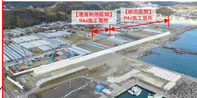
種崎(外縁)工区 港湾利用区間・砂浜区間 本体工(R5.1撮影)
