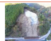
安田東洋線（安田町平瀬地区）
