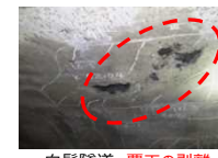
白髪隧道 覆工の剥離
