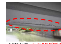
松田川橋 主桁のひび割れ
