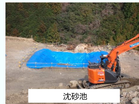
濁水処理設備
