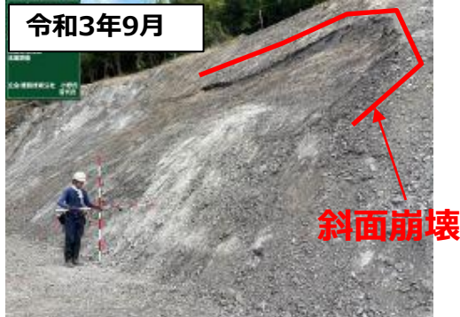
1:1.0勾配斜面 施工中の崩壊状況
