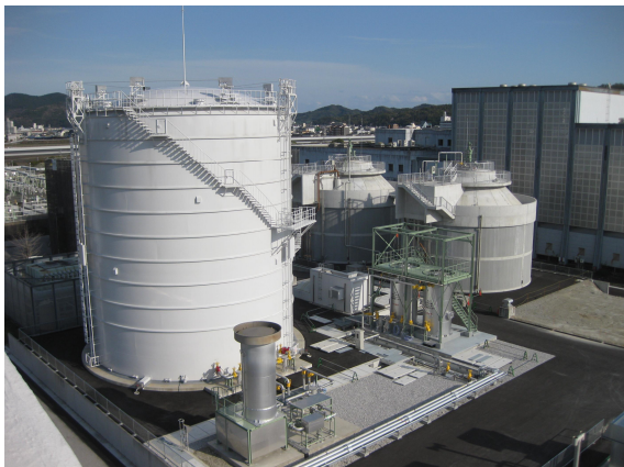
消化施設（高須浄化センター）
