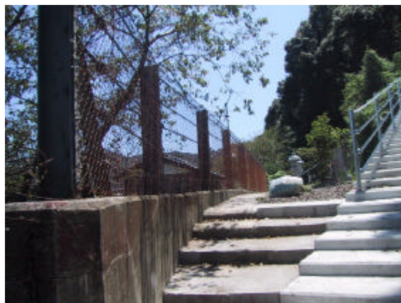
写真 7-20 上ノ加江バス停西墓地登口付近 (防護柵腐食)
