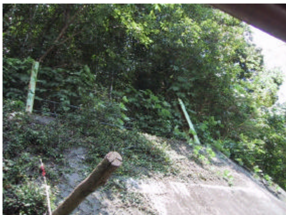
写真 7-19 上ノ加江小学校南付近 (防護柵腐食)
