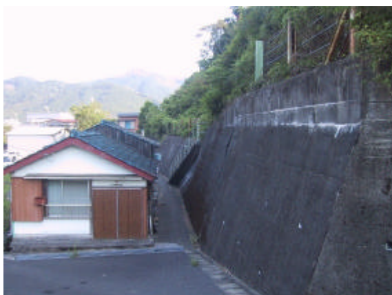
写真 7-21 両栄橋南東付近 (防護柵腐食)
