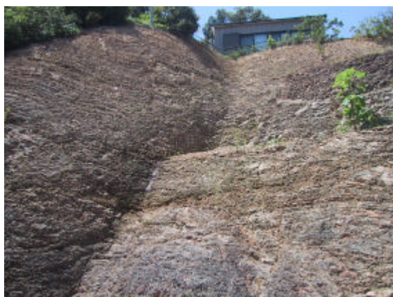
写真 7-13 上ノ加江小学校西付近 (風化著しく礫状となり、部分的に表層剥離)
