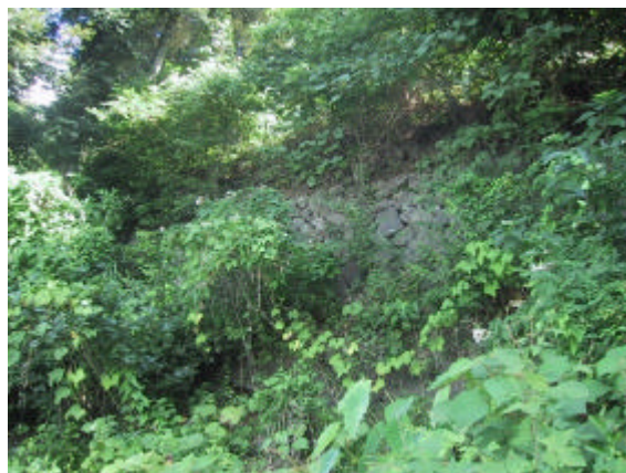
写真 7-18 上ノ加江バス停西墓地登口付近 (古い石積混合擁壁で空隙多く不安定)
