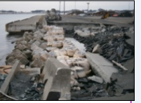
〔岸壁被災状況〕 (写真提供：東北地方整備局)
