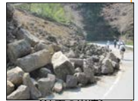
〔法面の崩壊〕 (写真提供：仙台市)
