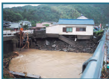
護岸侵食状況
