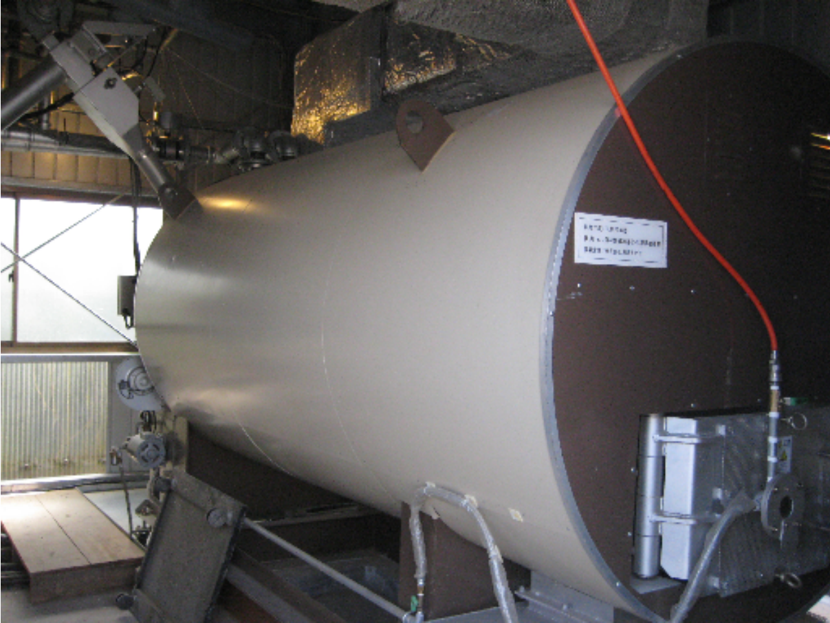
(株)東洋トピナ 木質ペレットボイラー 設備
