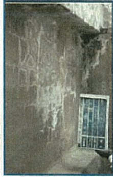
床版ひびわれ
