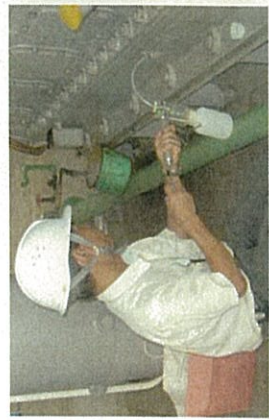
排水機場等機械設備の潤滑油分析による劣化診断
