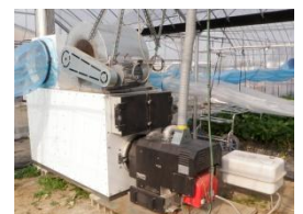
木質バイオマスボイラー
