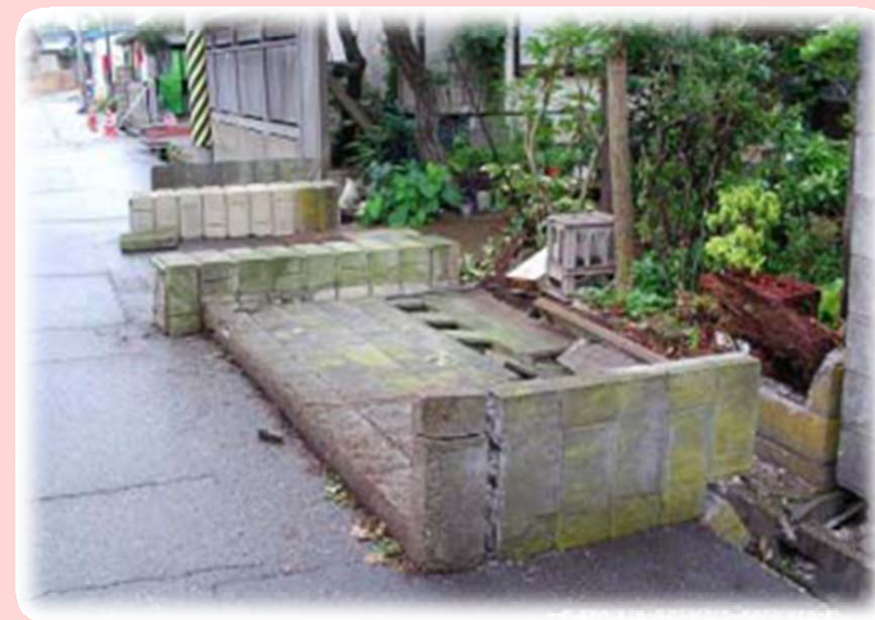
地震により倒壊したブロック塀 （平成19年新潟県中越沖地震）
