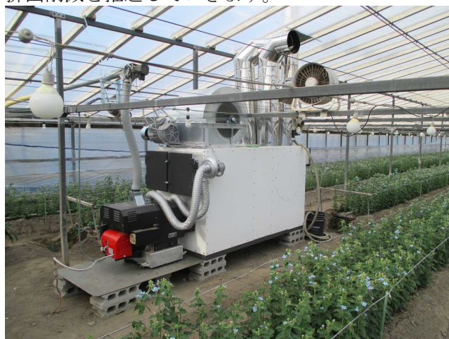
木質ペレットボイラー（芸西村）
