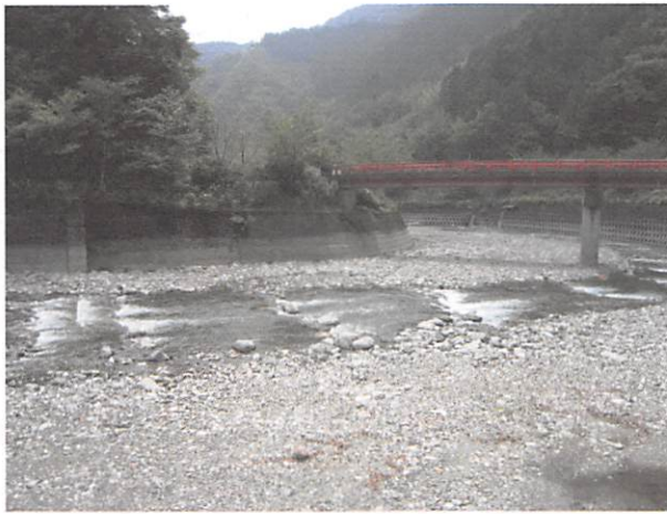
図3 2区（石構造物 分散型落差工 小湍の連続 （図2 Aより H19_06_27 撮影）
