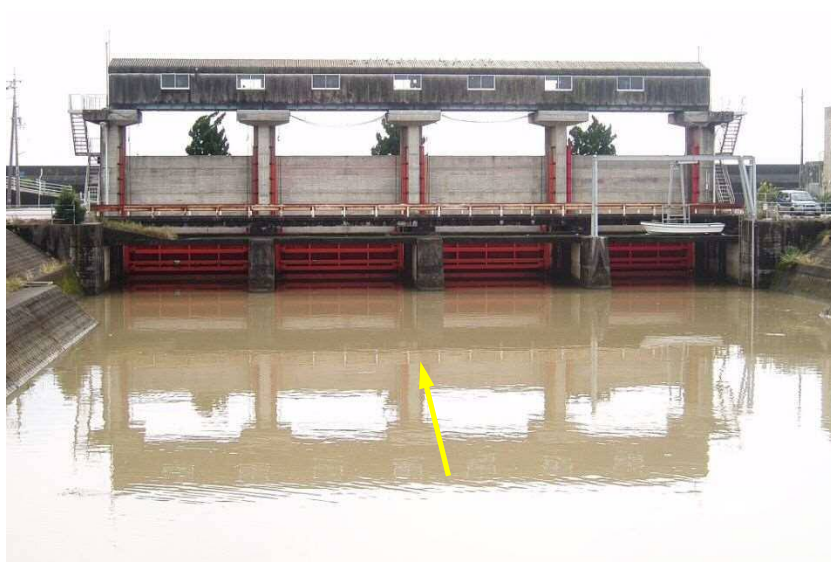
放水路防潮水門（派川香宗川）
