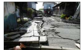
〔ブロック塀の倒壊〕
