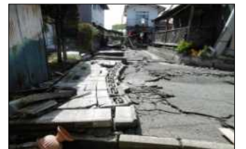
〔ブロック塀の倒壊〕
