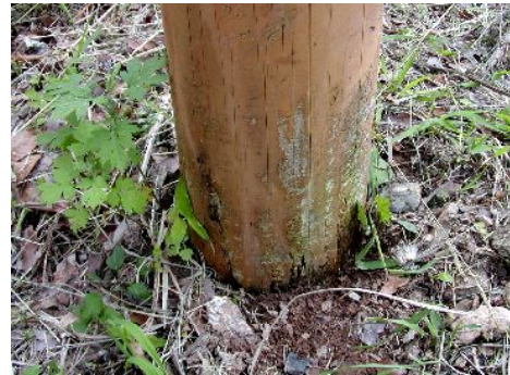
図19 地際部の軽微な劣化状況(補修前)
