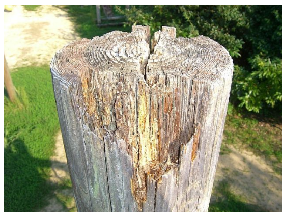
図16 遊具の柱先端部の劣化状況
