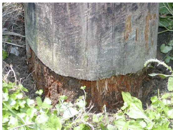
図14 遊具の柱地際部の劣化状況
