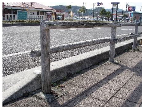
図29 歩行者自転車用柵(補修前)
