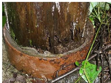
図22 地際部の劣化の進んだ状況(補修前)
