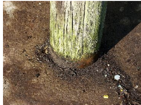
図26 柱地際部と基礎部の状況(補修前)
