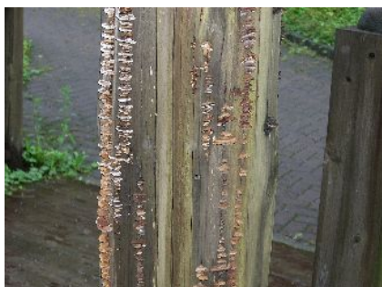
図2 パーゴラの柱に発生したキノコ
