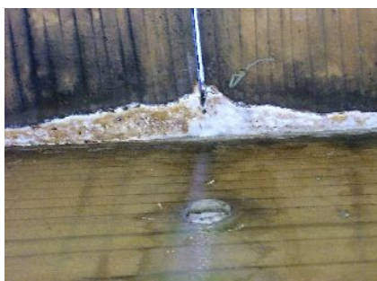
図4 デッキの裏面に発生した菌糸
