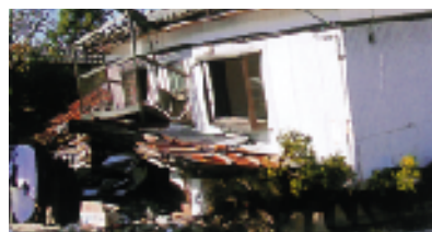
新潟県中越地震による家屋倒壊(新潟県長岡市)
