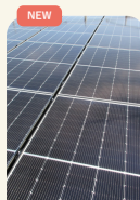
太陽光発電システム
