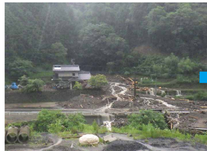
平成30年豪雨災害による土石流(栲原町下西の川(河主谷川))
