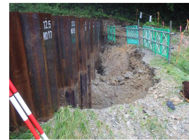
【ため池の崩落状況】
