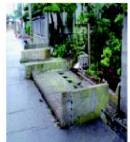
【倒壊したブロック塀】
