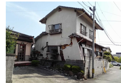
＜地震により被災した住宅＞
