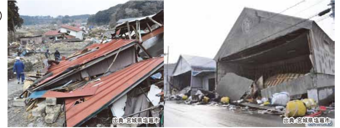
【東日本大震災の建物被害】
