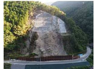
安田東洋線（安田町平瀬地区）
