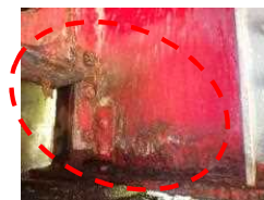
新大森橋の損傷状況
