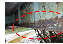
美舞橋の損傷状況
