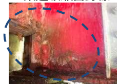
新大森橋の損傷状況
