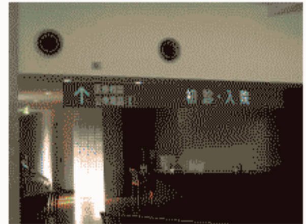
2階初診受付前の頭上にある吹き出し口
