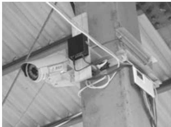
写真4 柱に設置したアクセスポイント（中央）
