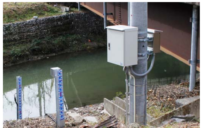
高知県日高村設置
