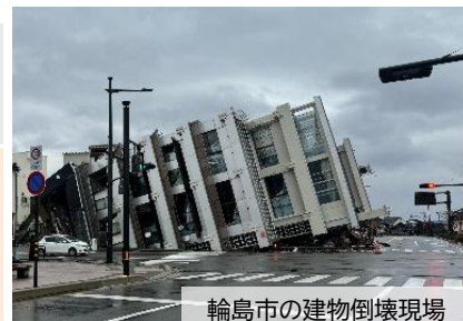
輪島市の建物倒壊現場
