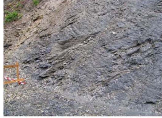
流れ盤構造の片理面に沿った剥離崩落(切土時) 時間経過とともに同様の剥落の危険性が高くなる
