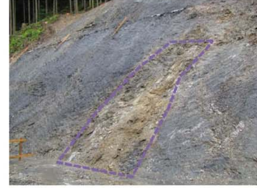
黄褐色の強風化脆弱部 周囲岩より軟質 湧水が確認される
