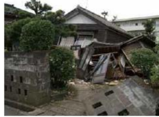
【全壊】一見して住家全部が倒壊
