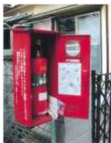
街頭消火器設置ボックス
