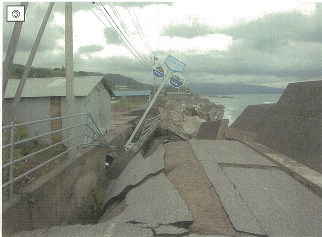
自転車道・防潮堤欠壊
