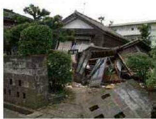
【全壊】一見して住家全部が倒壊
