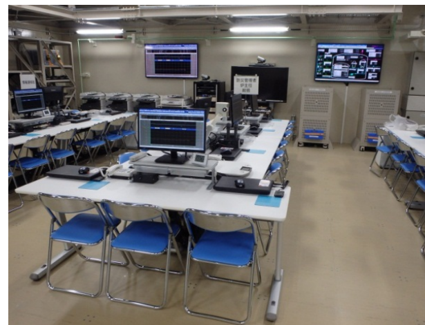
緊急時対策所の内部
