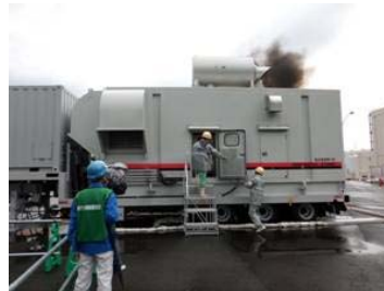
空冷式非常用発電装置
