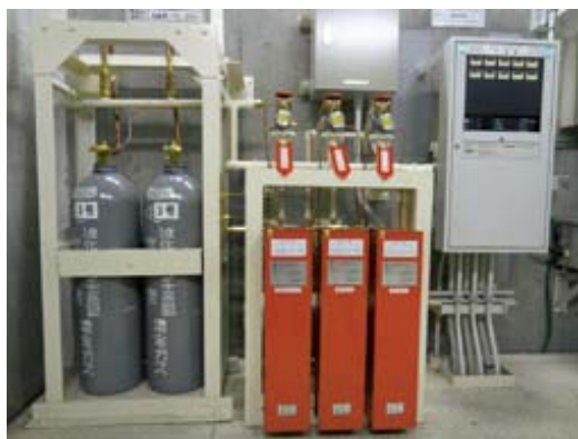
ハロン自動消火設備
