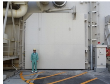
大型水密扉等 (T.P.+約14m) ※自主的な対策
