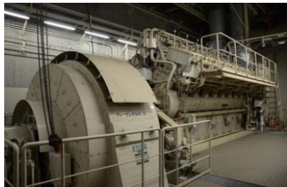
非常用ディーゼル発電機 (既設)
