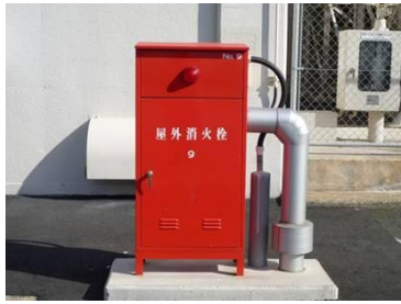
消火栓設備（原子炉施設等の 建屋内、構内）
