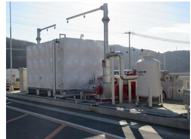
泡消火設備（重油タンク）
