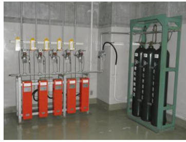
二酸化炭素消火設備（タービン油 タンク、補助ボイラ室）
