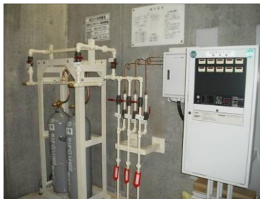
ハロン消火設備（中央制御室フ ロアケーブルダクト、タービン 発電機（軸受部））
