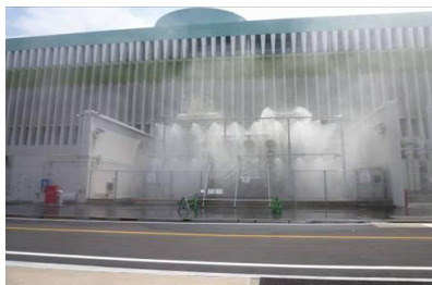
水噴霧消火設備（主変圧器、 所内変圧器、予備変圧器）
