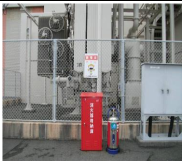
消火器（原子炉施設等の建屋内、 構内）
