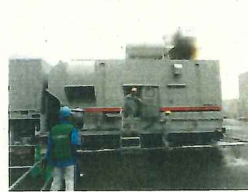
空冷式非常用発電装置
