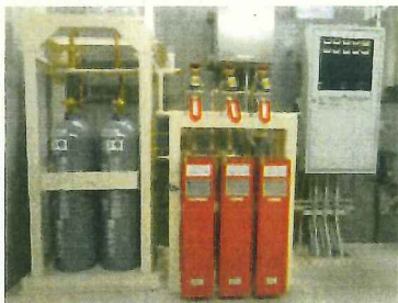
ハロン自動消火設備
