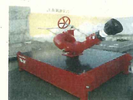
放水砲（大型2台）
