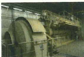
非常用ディーゼル発電機(既設)
