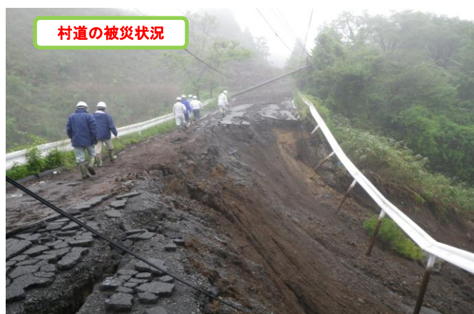
※村道被災により、徒歩で山地災害箇所に現地確認へ
