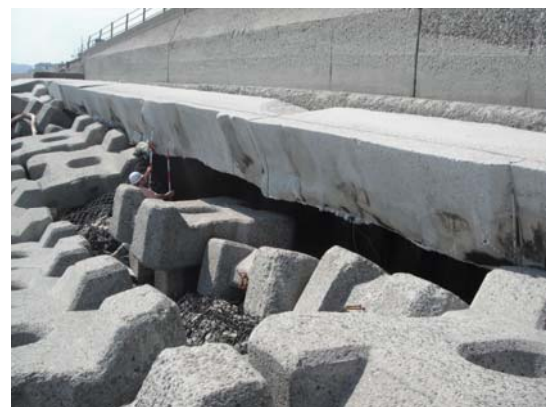
〔長浜海岸被災状況（高知市）〕
