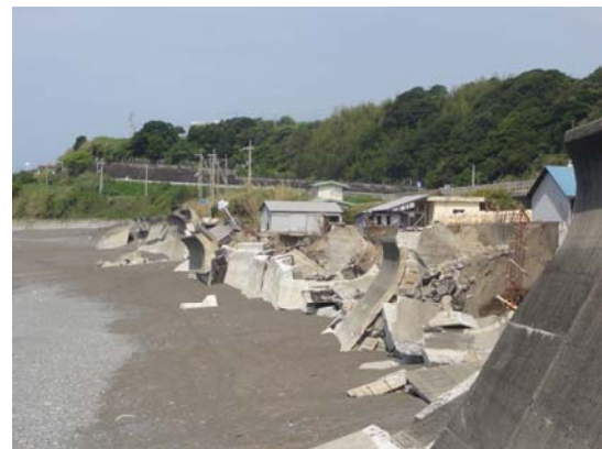
〔穴内海岸被災状況（安芸市）〕
