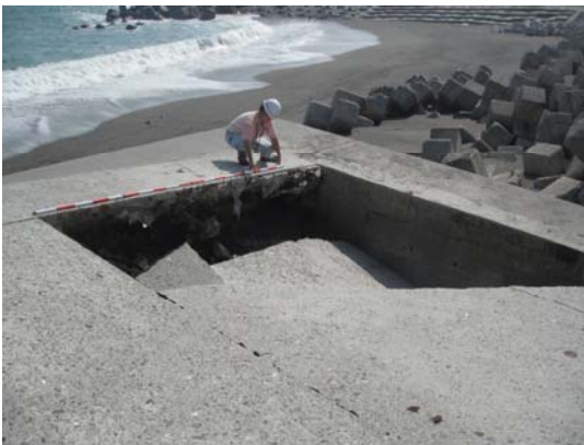
〔戸原海岸被災状況（高知市）〕
