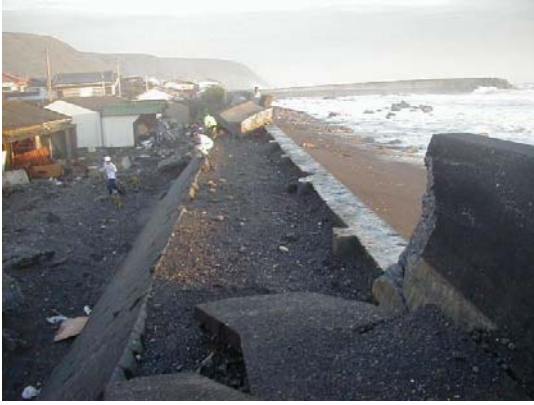
〔菜生海岸被災状況（室戸市）〕
