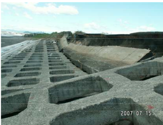
〔吉川海岸被災状況（香南市）〕
