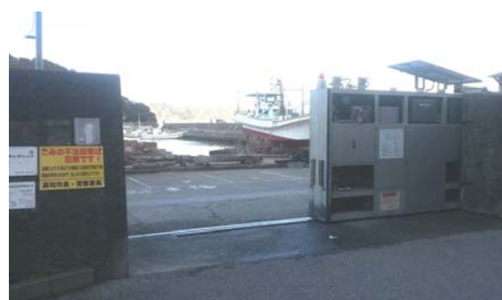
〔陸閘機械化 事例〕
