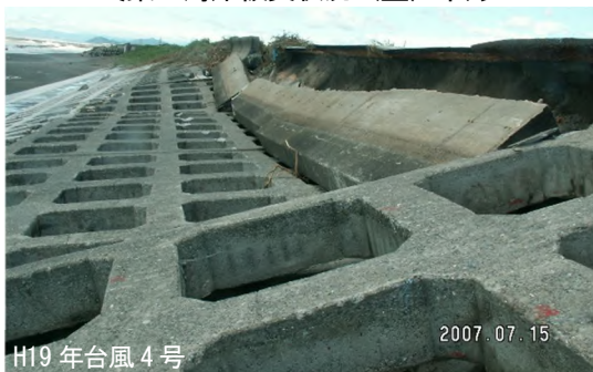
〔吉川海岸被災状況（香南市）〕
