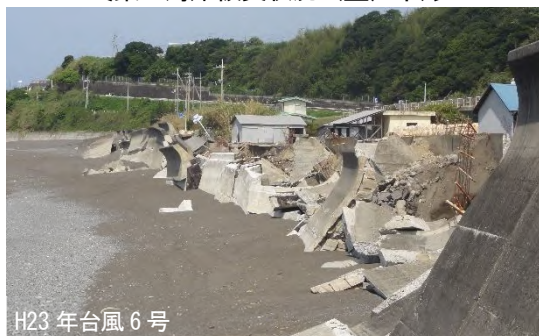
〔穴内海岸被災状況（安芸市）〕
