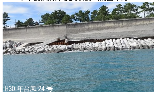
〔長浜海岸被災状況（高知市）〕
