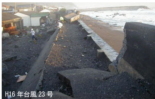
〔菜生海岸被災状況（室戸市）〕
