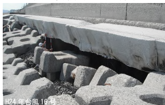
〔長浜海岸被災状況（高知市）〕
