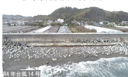
〔十市前浜海岸被災状況（南国市）〕
