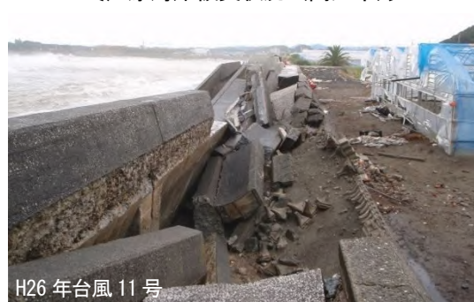
〔十市前浜海岸被災状況（南国市）〕
