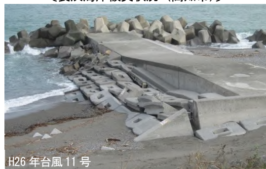
〔戸原海岸被災状況（高知市）〕
