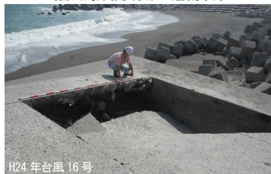
〔戸原海岸被災状況（高知市）〕
