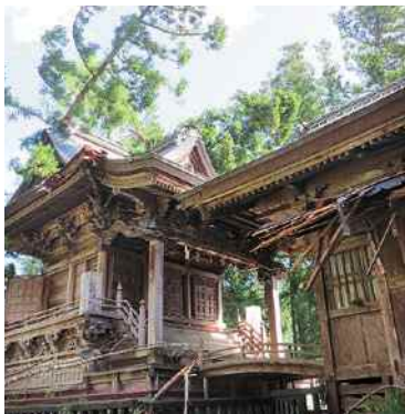
台風被害を受けた 大川上美良布神社社殿
