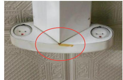
蛍光灯安定器の劣化により蛍光灯機器から PCB 油が漏れ出した例
