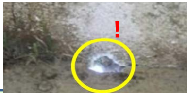
壁や床の破損がないか(外の光が漏れている所は要注意)
