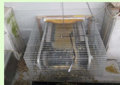
集卵用コンベアや除糞ベルトの開口部の隙間対策。(写真は、稼働時以外はカバーを設置し、隙間をなくしている事例。)
