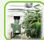
環境制御装置
