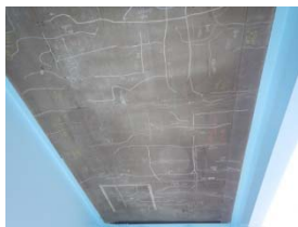
▲ 床版ひびわれ状況
