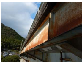
▲ 塗装の劣化状況
