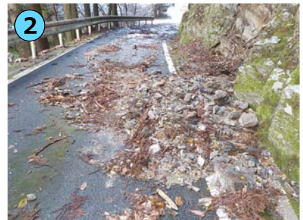
▲県道川之江大豊線の落石状況 (H28 落石件数353件)
